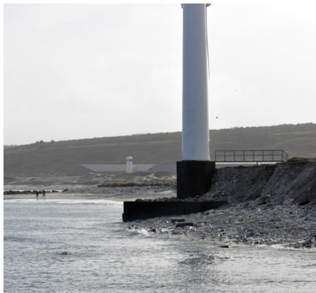
Foto 7.2. Erosion omkring eksisterende mølle
